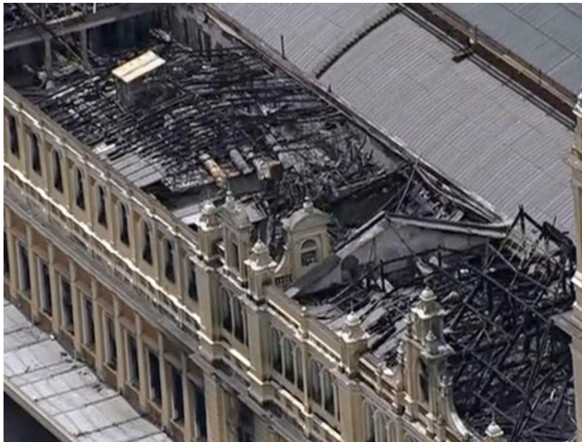
Figura 09 - Vista geral da estação da luz após o incêndio. Fonte: Reportagem globo.com - 17/08/2016
