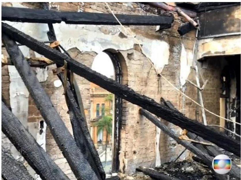
Figura 07 - 1º pavimento - estrutura Fonte: Reportagem globo.com - Data: 17/08/2016
